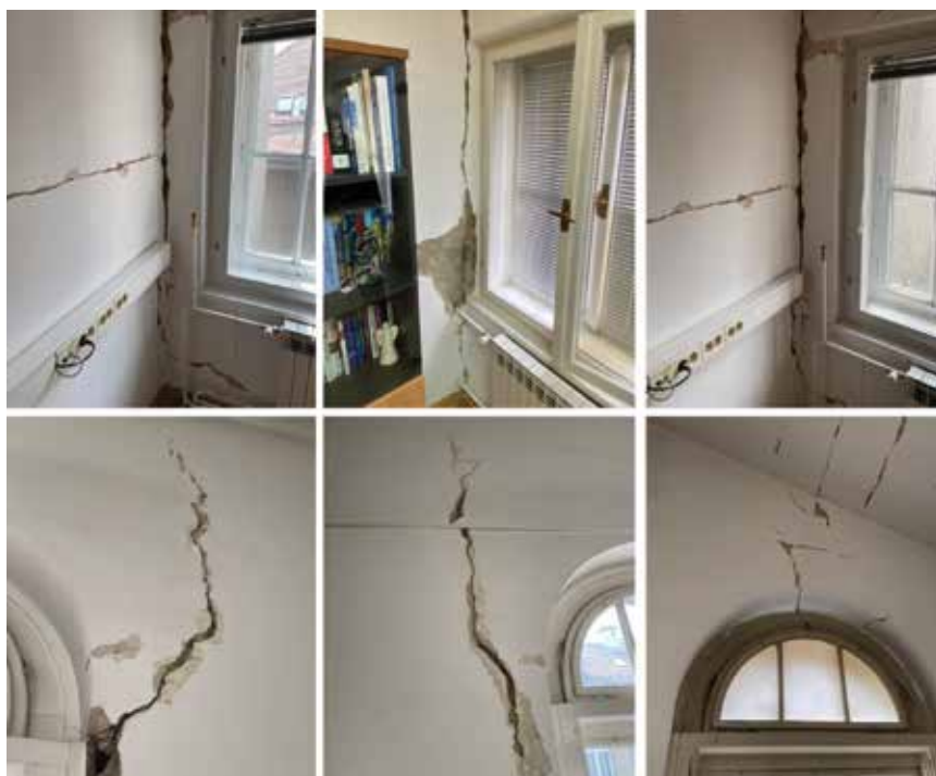
Na unutrašnjim nosivim zidovima evidentirane su karakteristične pukotine na velikome dijelu
