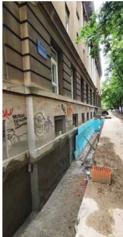
Saniranje oštećenja od kapilarne vlage
