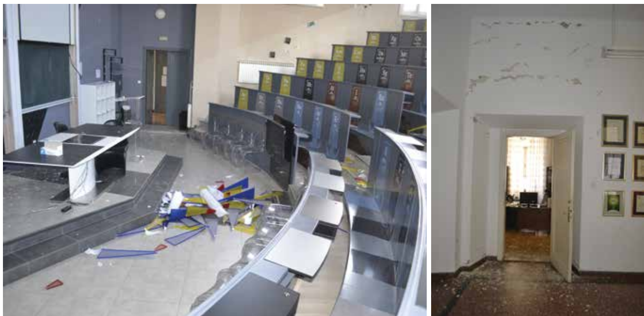
Oštećenja nakon potresa na zgradi u razdoblju od ožujka 2020. do travnja 2021.
