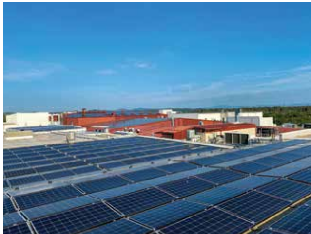
Pogled na fotonaponske panele na krovu PPK karlovačke mesne industrije
