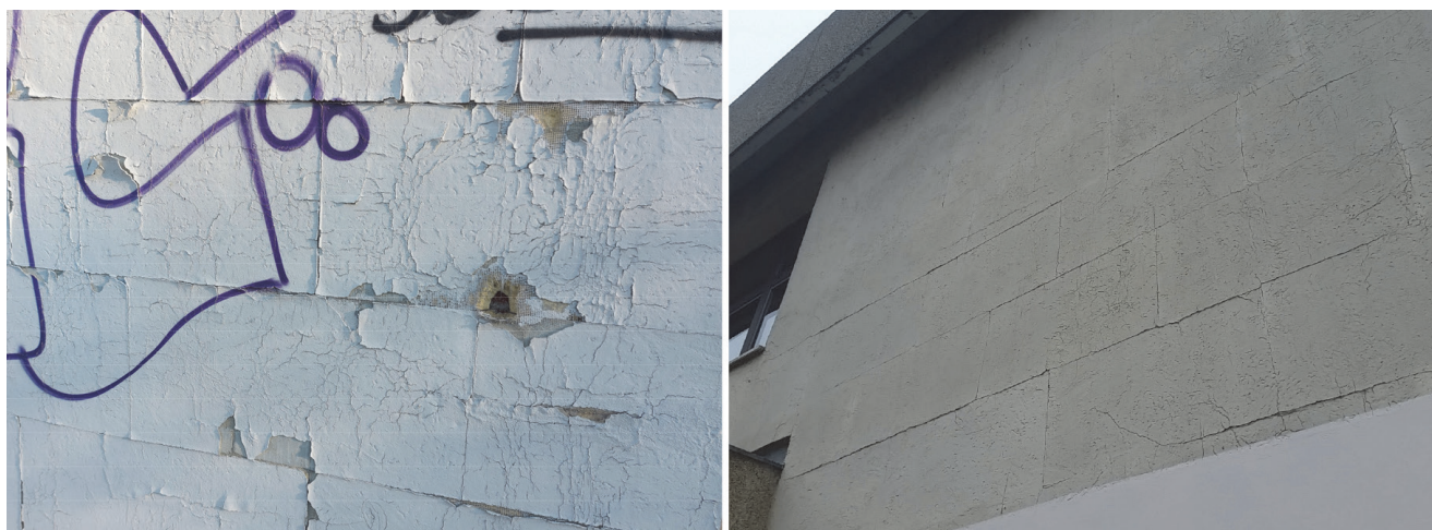
Slika 1. Primjer popucalih završnih slojeva ETICS sustava zbog deformiranja ploča EPS-a
