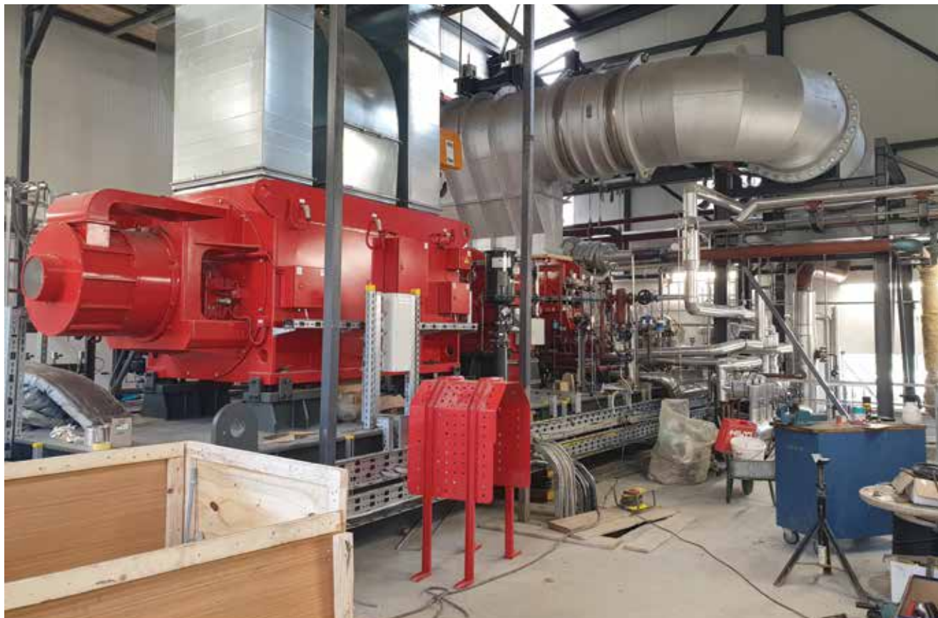
Pogled na turbogeneratorski set u postrojenju
