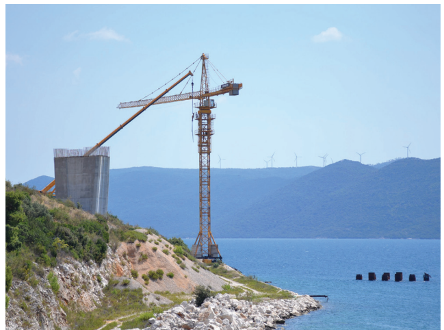
Pogled na napušteno gradilište nakon raskida ugovora o gradnji 2012.
