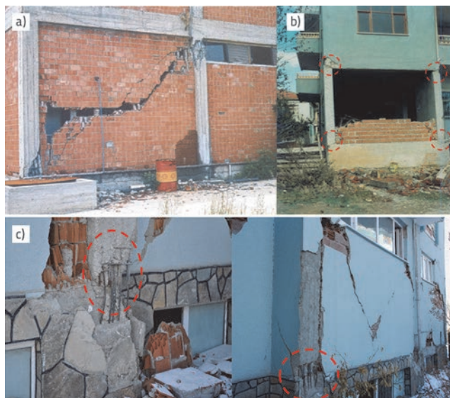
Slika 1. Oštećeni okvir s ispunom: a) potres Adana-Ceyhan iz 1998. [3]; b) potres Dinar iz 1995. [4]; c) potres Van iz 2011.
