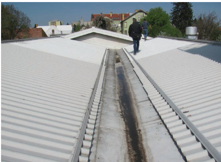
Dotrajala krovna konstrukcija
