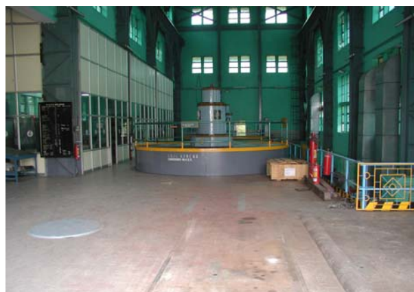
Slika 12. Strojarnica hidroelektrane „Sholayar I“
