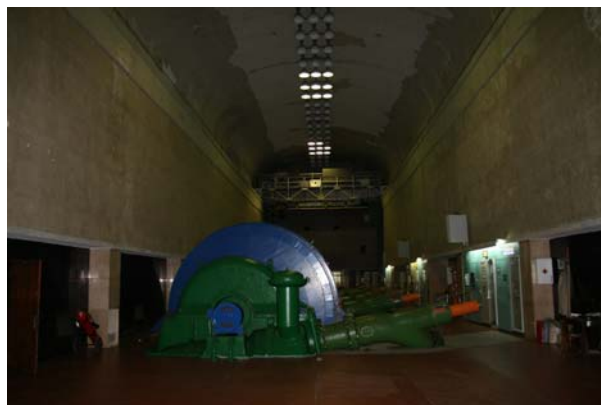
Slika 14. Interijer strojarnice hidroelektrane „Vinodol“ danas
