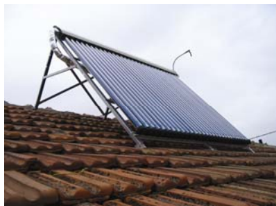
Estetski neprikladno postavljen solarni kolektor
