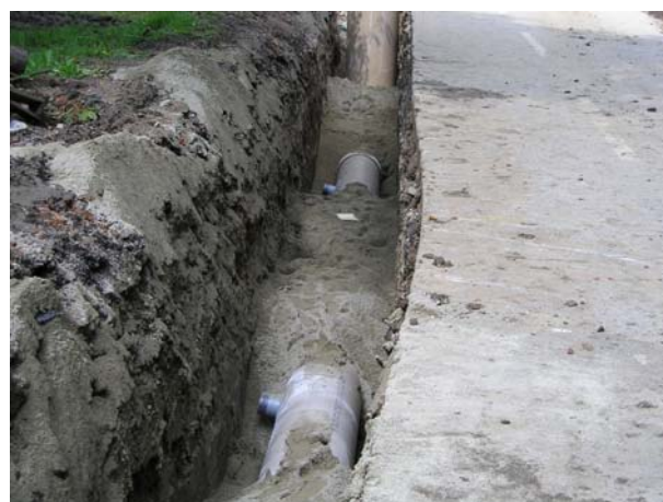
Slika 3. Sekundarni kolektor u Lađarskoj ulici
