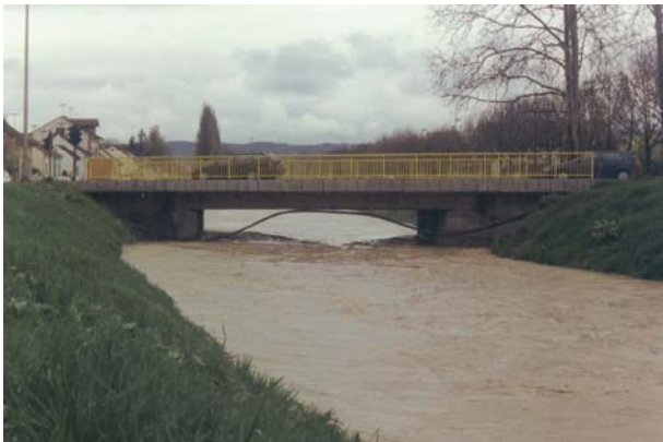
Slika 5. Most u Strossmayerovoj ulici na ILK-u tijekom poplave
