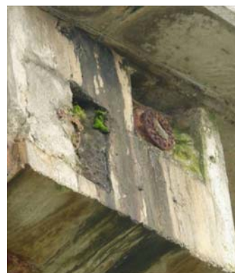
Slika 24. Otpadanje zaštite kotvi natega za prednapinjanje naglavne grede stupa nadvožnjaka tipa SO
