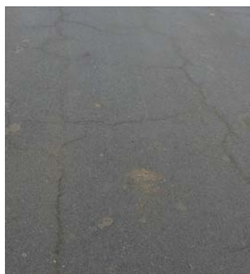
Slika 29. Asfalt prošaran pukotinama
