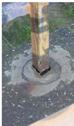
Slika 37. Gubitak presjeka stupića ograde na mjestu usidrenja u hodnik
