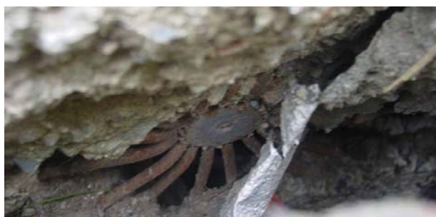
Slika 13. Kotva prednapetih kabela glavnih nosača vidljiva s kolnika nadvožnjaka tipa SO
