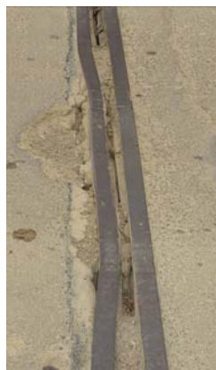
Slika 36. Primjer oštećenja prijelazne naprave
